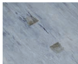
Verfärbung und Eindrücke durch ungeeignete Rollen
