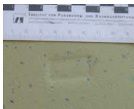
Schadensbild durch scharfkantigen Möbelfuß
